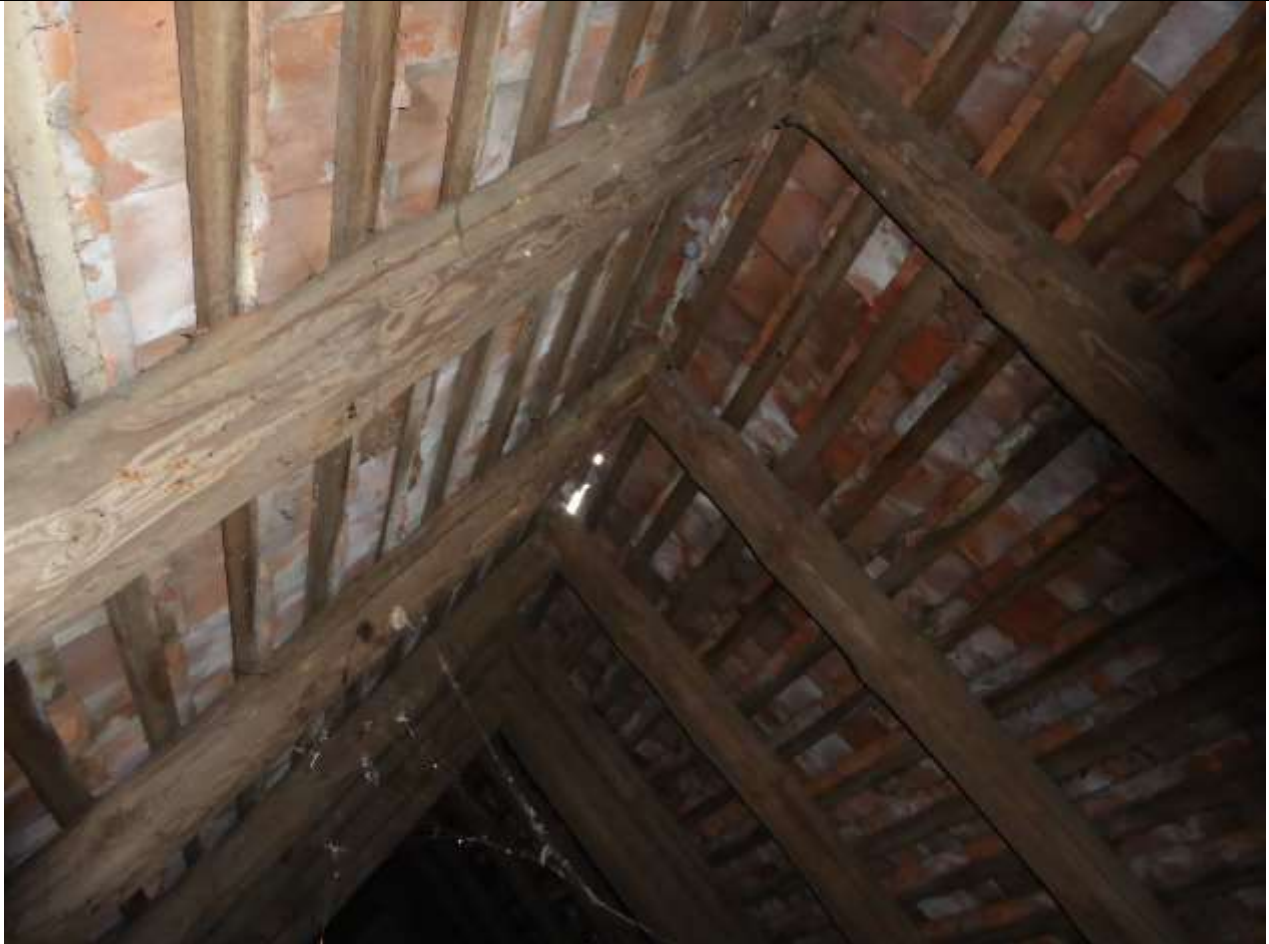
Dachfirst mit Lücken: kein Wärmestau im Dachboden möglich
