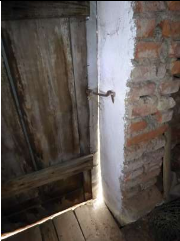
Dachboden mit offenen Seitenverschlag: zugig und Lichteinfall
