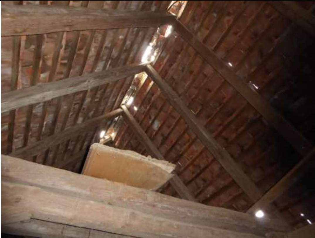
Dachfirst mit umfangreichen Lücken: kein Wärmestau im Dachboden möglich, starker Lichteinfall
