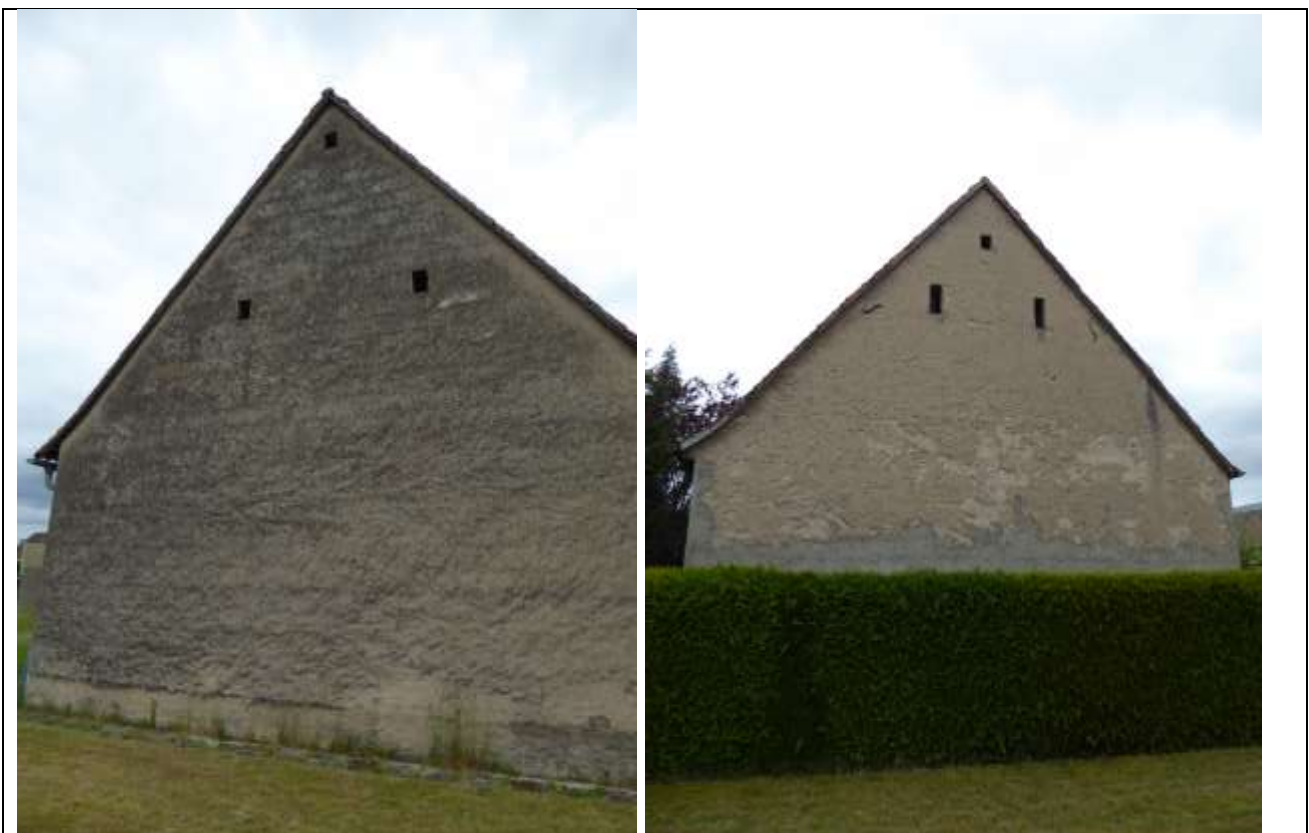
Seitenwand: mit drei Öffnungen im Dachboden pro Seite: kein Wärmestau im Dachboden möglich, sondern hell und zugig: als Fledermausquartier ungeeignet
